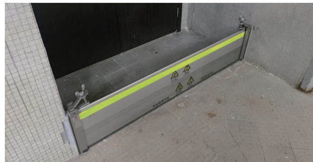
富豪機場酒店的防洪閘
