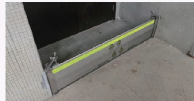
富豪機場酒店的防洪閘
